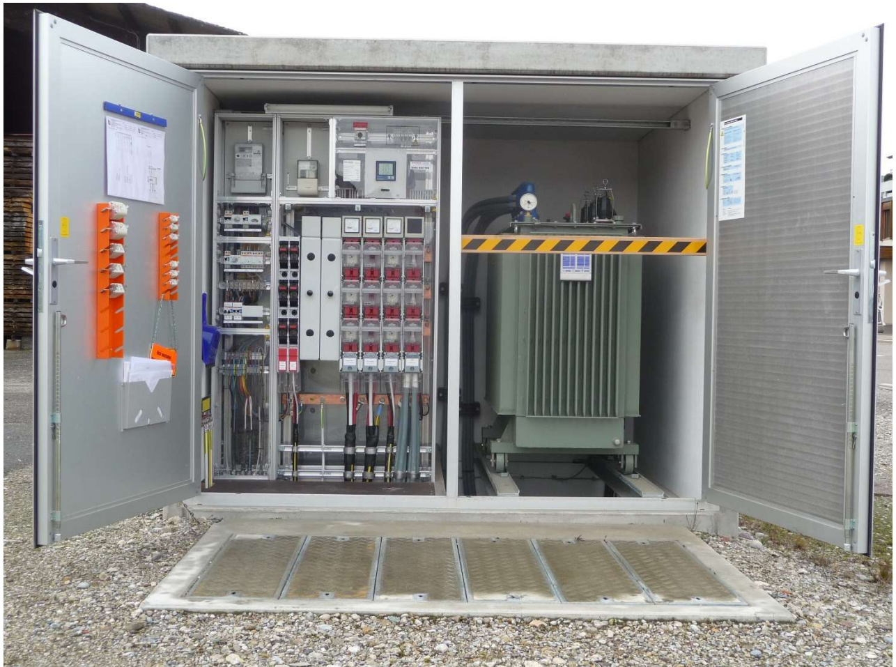
Trafostation See an der Kaiserstuhlerstrasse
