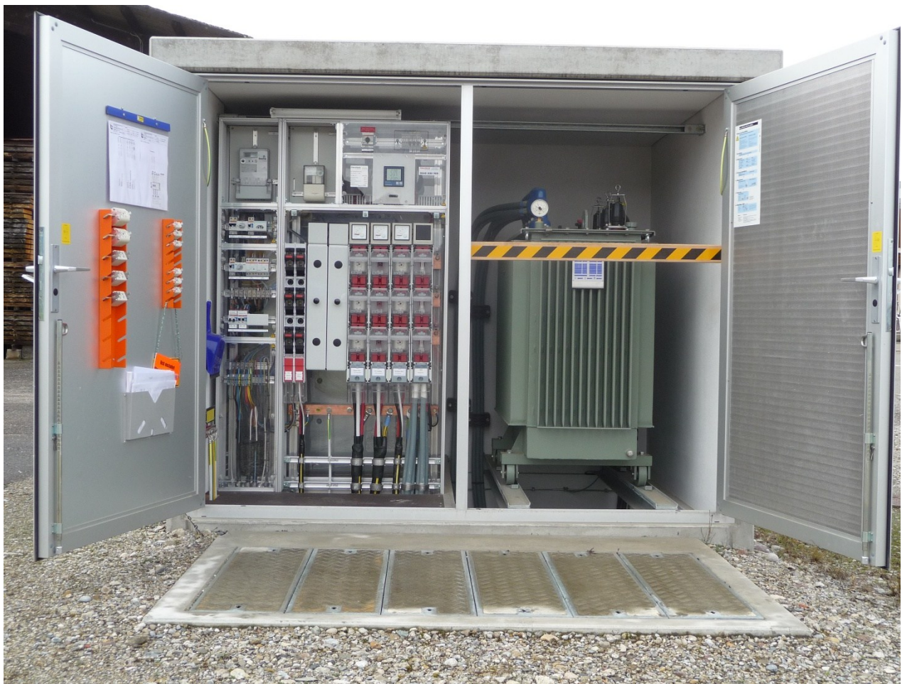
Trafostation See an der Kaiserstuhlerstrasse
