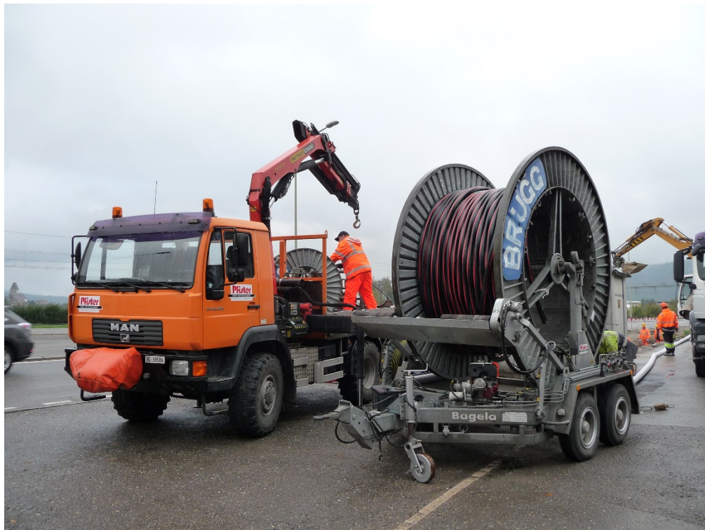
HS Kabel an der Kaiserstuhlstrasse
